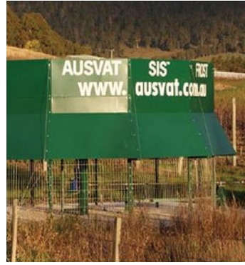
Plate 2: Horizontal fan system.
